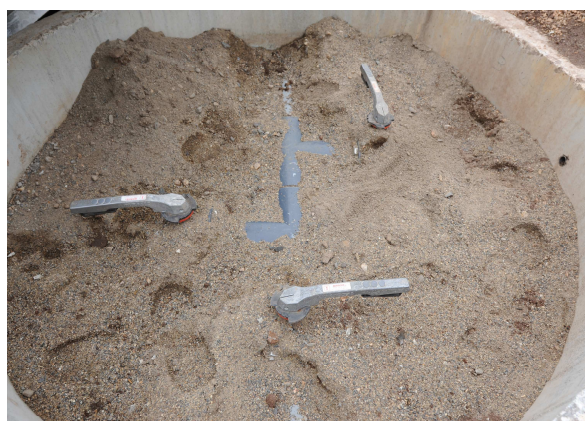
Dispositif de sélection des filtres par vannes
