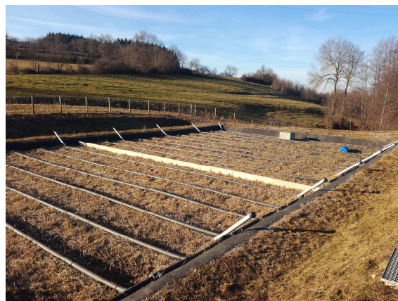
Deuxième étage de filtres plantés de roseaux
