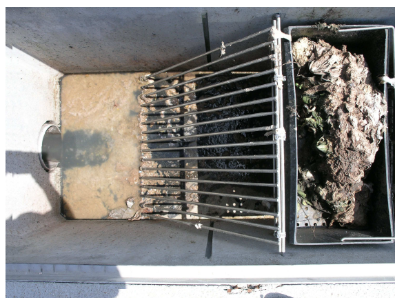
Stockage temporaire des refus de dégrillage
