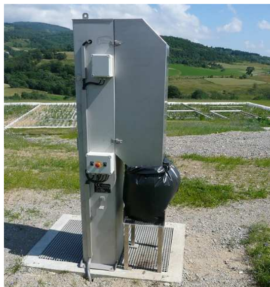
Dégrillage droit à nettoyage automatisé
