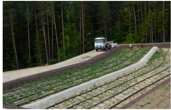
Désherbage manuel des filtres du deuxième étage au printemps. Cette opération n'est plus à réaliser lorsque la densité des roseaux est suffisante
