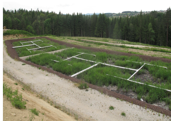
Premier étage de filtre
